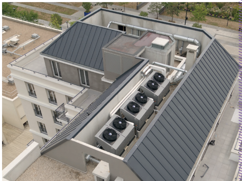
Installation en cascade de pompes à chaleur HRC 80 kW double service. @ Groupe Intuis
